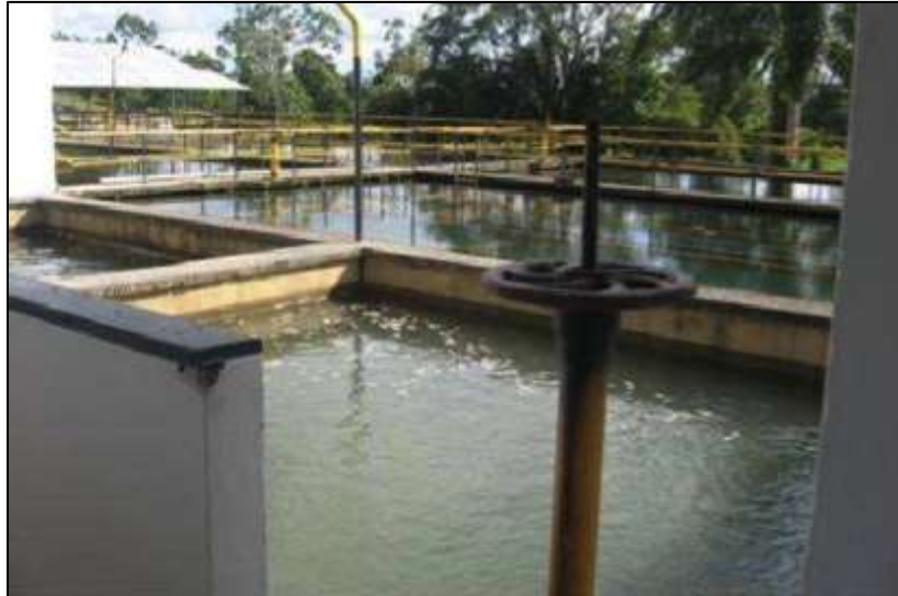
Fotografía 2-15 Planta de potabilización
