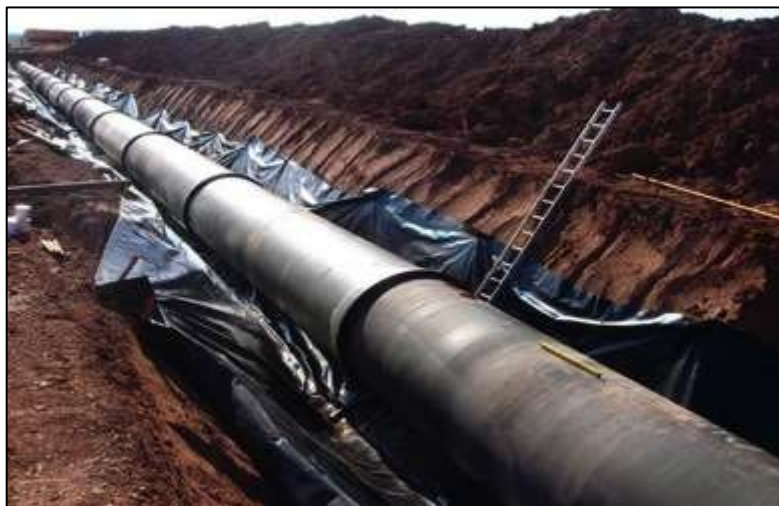
Fotografía 2-13 Tubería en hierro dúctil con juntas campana-espigo
