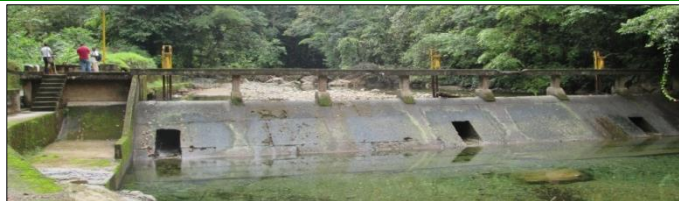
Fotografía 1-5 Rejas de Captación Bocatoma 2
