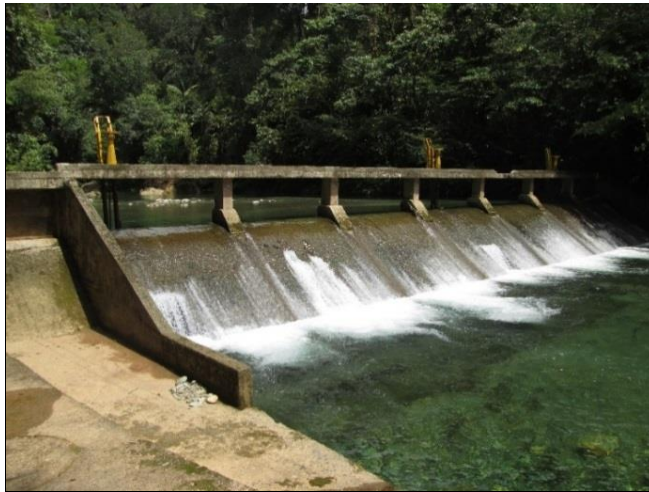
Fotografía 3-2 Características generales puntos de monitoreo- bocatoma Río Escalerete
