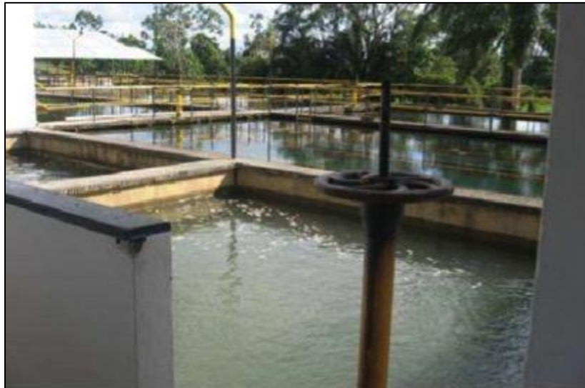
Fotografía 2-15 Planta de potabilización
