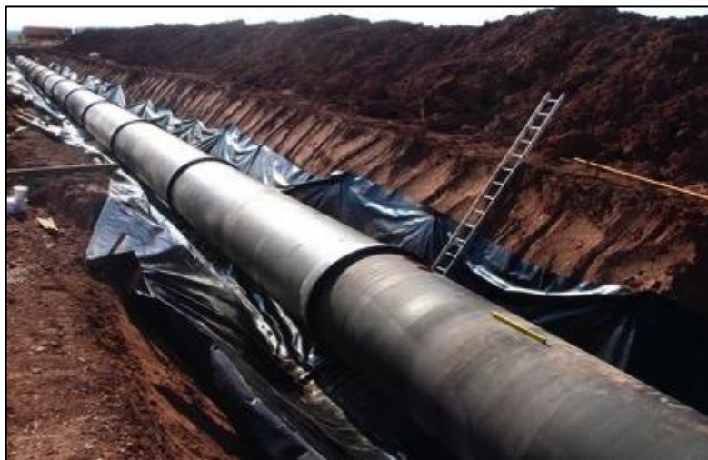
Fotografía 2-13 Tubería en hierro dúctil con juntas campana-espigo
