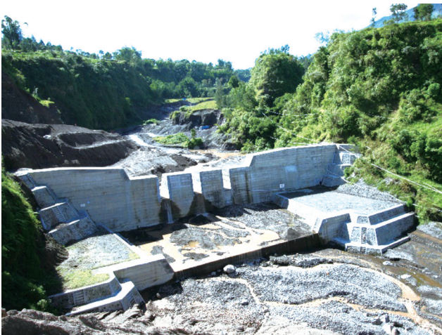
日本の技術を活用した砂防施設整備（インドネシア）
