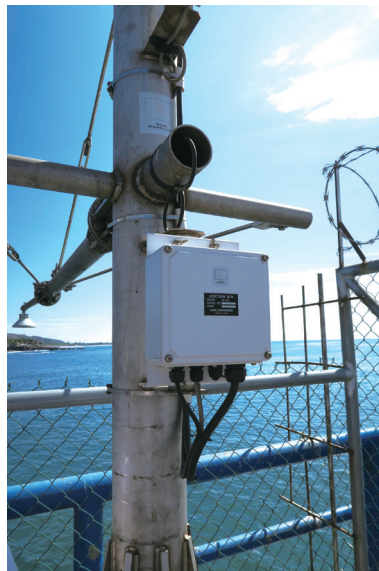
日本製の潮位計測システムが導入された港（エルサルバドル）
