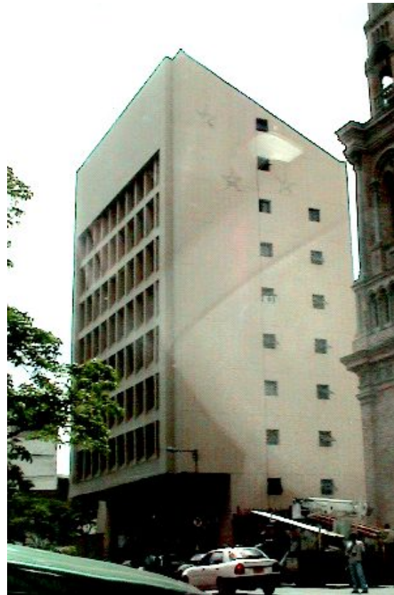
Pórticos débiles rellenos de mampostería (Sistema 09)
