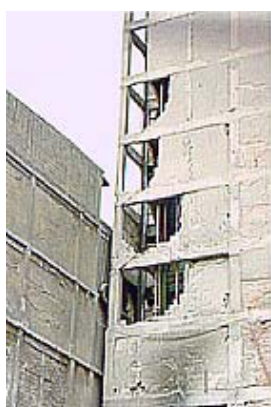
Edificio dañado por golpeteo
