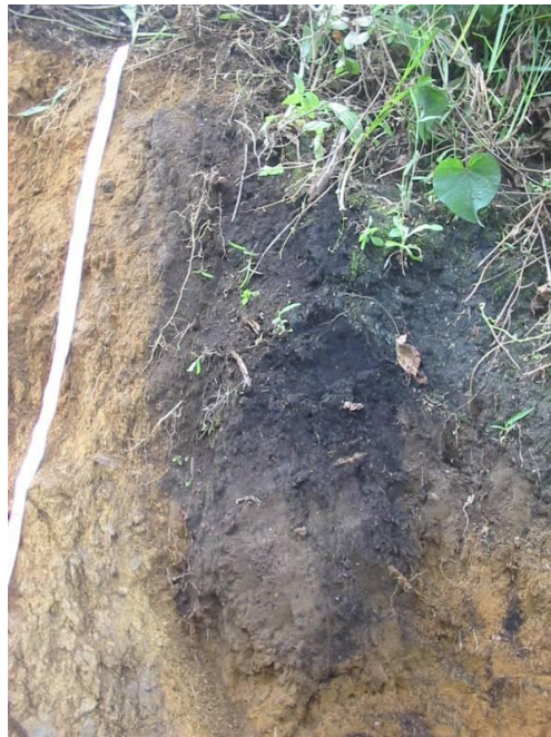
Foto 5.17 Detalle del suelo desplazado y contacto con depósito de vertiente
