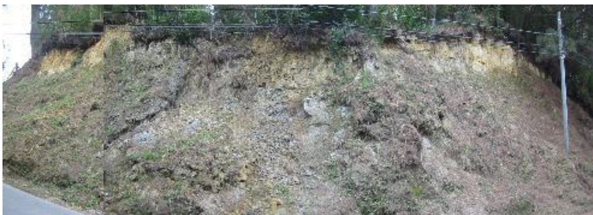
Foto 5.4 Vista general del corte oriental de la vía afectado por el diaclasamiento
