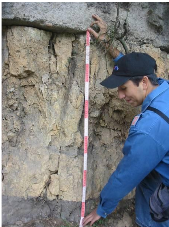
Foto 5.13 Intervención antrópica en la parte superior
