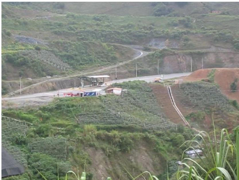
Foto 5.19 Zona de las casetas de peaje del portal occidental del túnel. La zona presenta cultivos y está intervenida hacia el oriente del afloramiento, pero no se encuentran evidencias que sugieran que se trata de un deslizamiento
