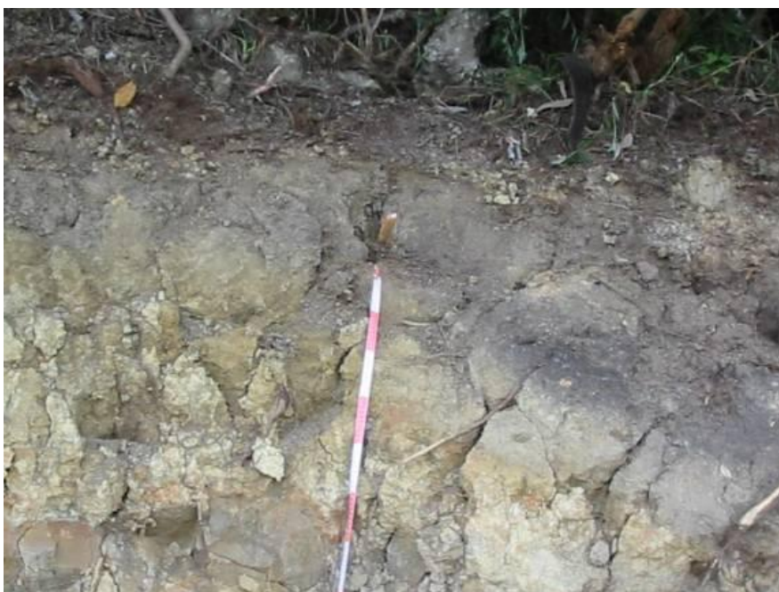
Fotos 5.5 y 5.6 Corte de la vía Caravanchel – El Retiro afectado por el diaclasamiento
