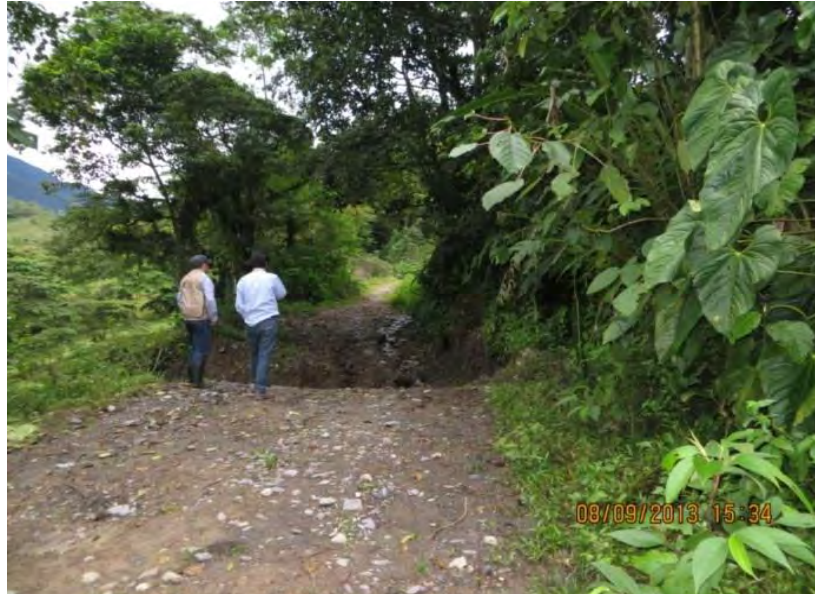
Fotografía 18. Afectación en la vía. Vereda Carichana.
