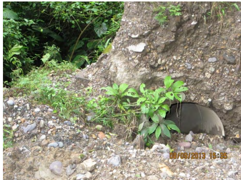
Fotografía 19. Alcantarilla destruida por el movimiento del terreno.
