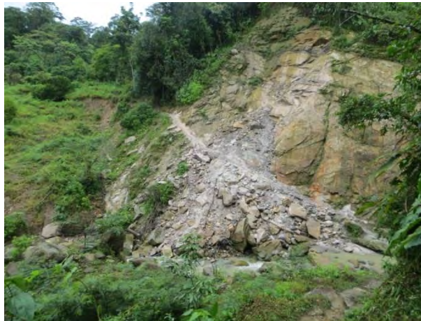
Fotografía 18. Zona afectada por el deslizamiento
