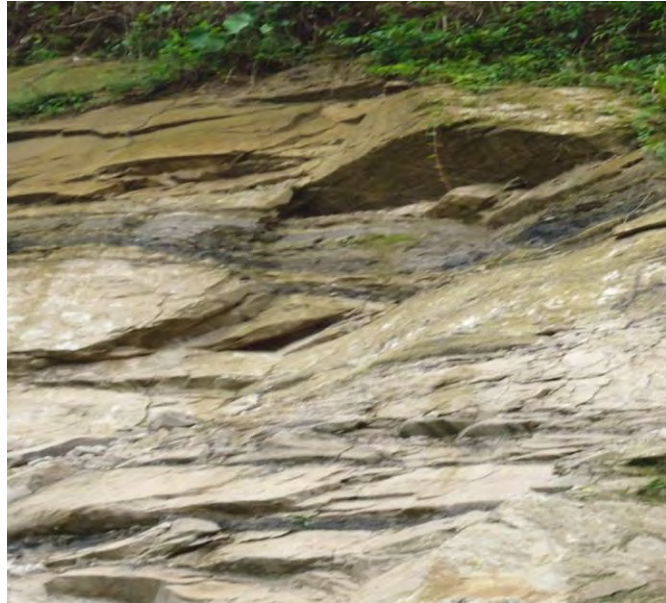
Fotografía 11. Parte alta del deslizamiento.
