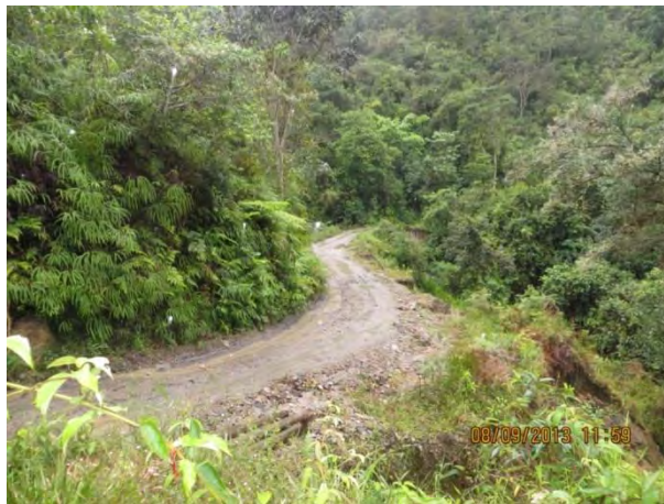
Fotografía 19. Vista del movimiento del terreno sobre la vía.
