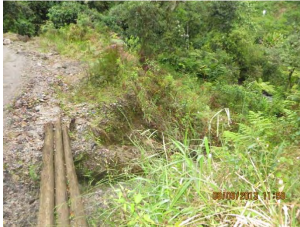
Fotografía 20. Afectación de la vía.
