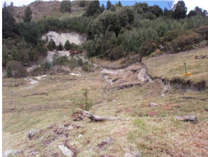
Fotografía 29. SE OBSERVA EL MATERIAL DESPLAZADO
