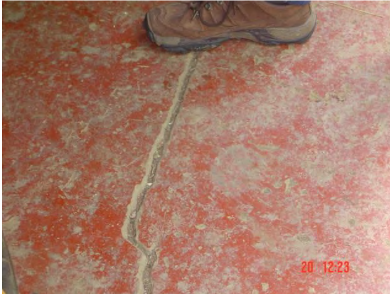
Fotografía 19. Pisos en mal estado en vivienda habitada
