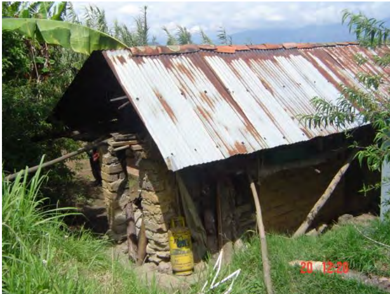
Fotografía 15. Vivienda afectada por el movimiento en masa.
