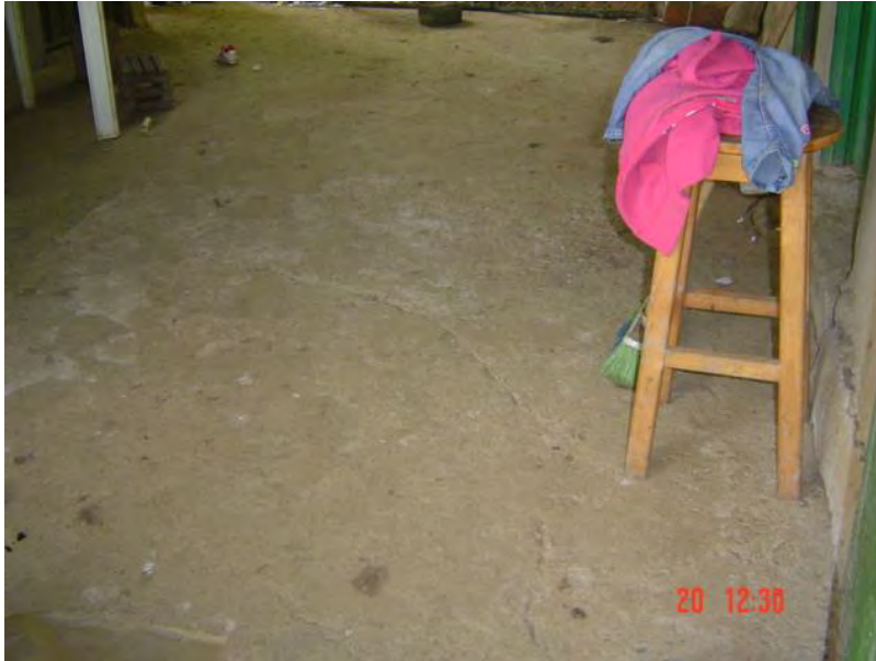
Fotografía 18. Pisos agrietados en vivienda habitada
