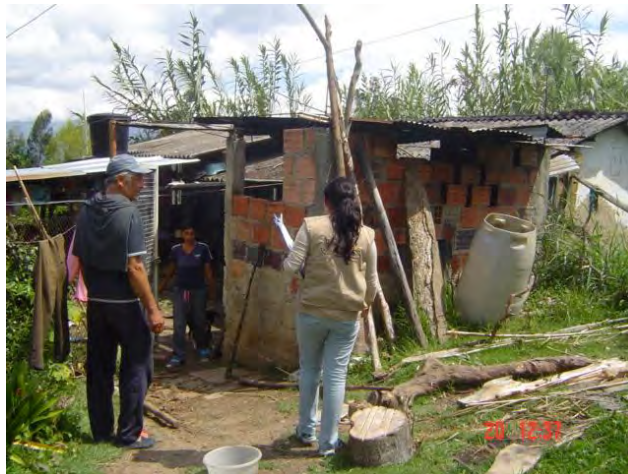
Fotografía 21. Vivienda con afectaciones fuertes en su estructura.
