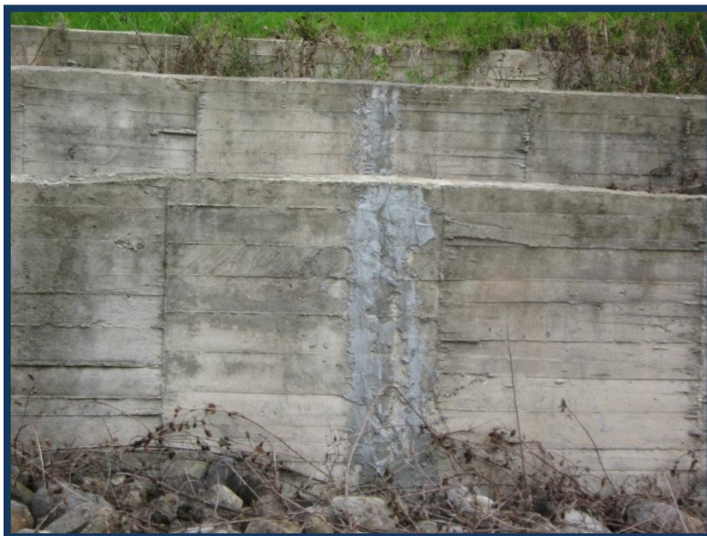
Fotografía 1. Grietas reparadas en la estructura de los tanques de Filtración.
