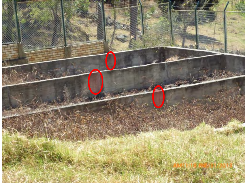
Fotografía 26. Grietas en los tanques.
