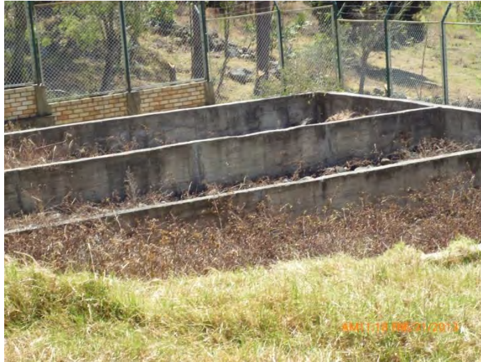
Fotografía 31. Parte interna de la planta (tanques decantadores).
