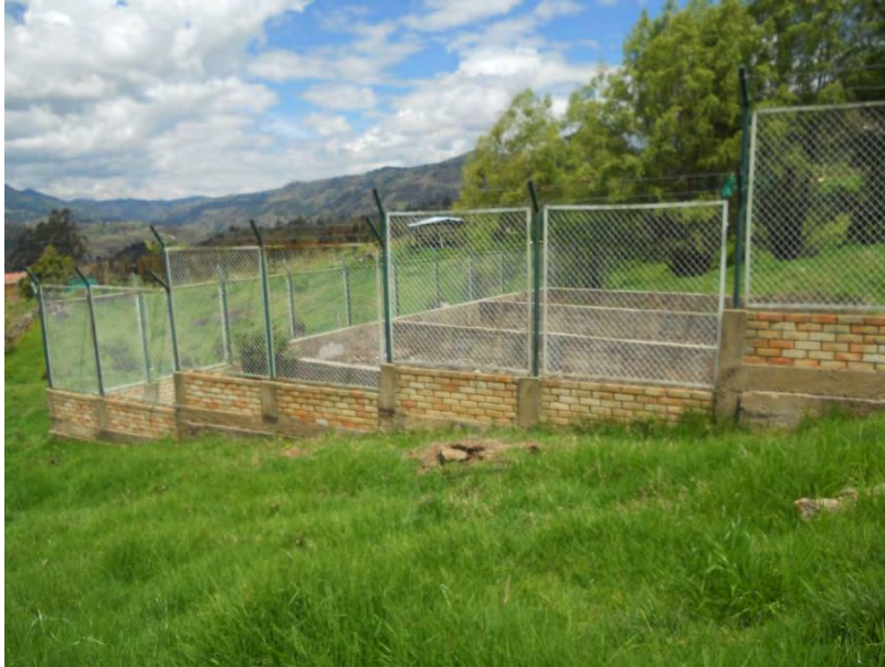
Fotografía 4. Planta para el tratamiento de aguas para el municipio de Nuevo Colon presente en la zona de estudio
