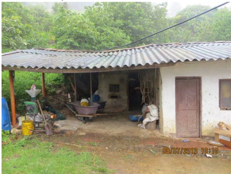
Fotografía 34. Vivienda afectada por el movimiento del terreno.
