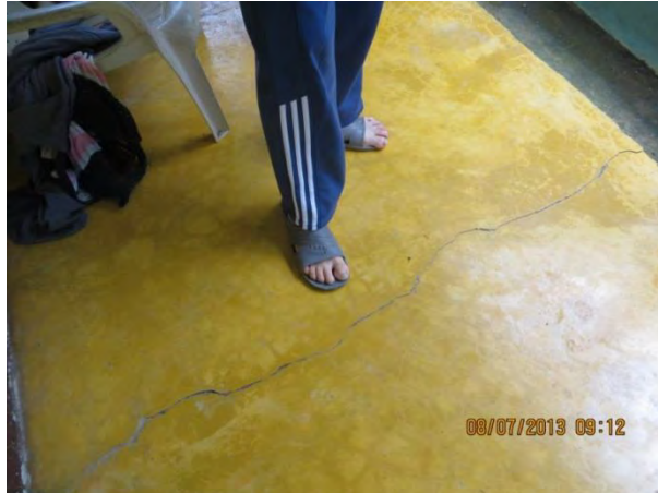
Fotografía 31. Agrietamiento de pisos.
