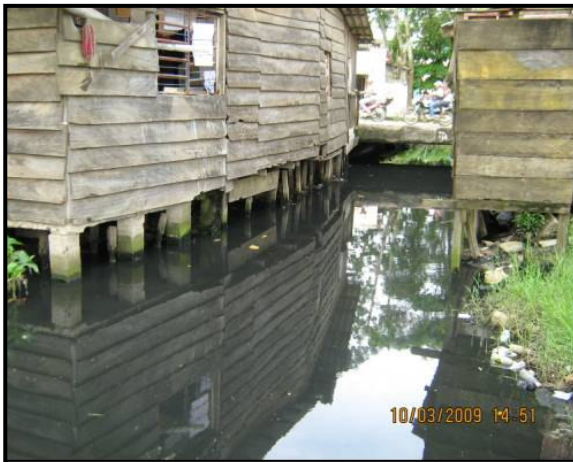
c) Ocupación del cauce paso por la zona urbana
