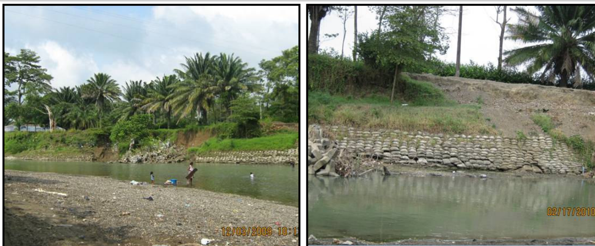
Figura 3-16. Depósito afectado por socavación lateral Río Chigorodó margen derecha sector K2+250 a K2+400
