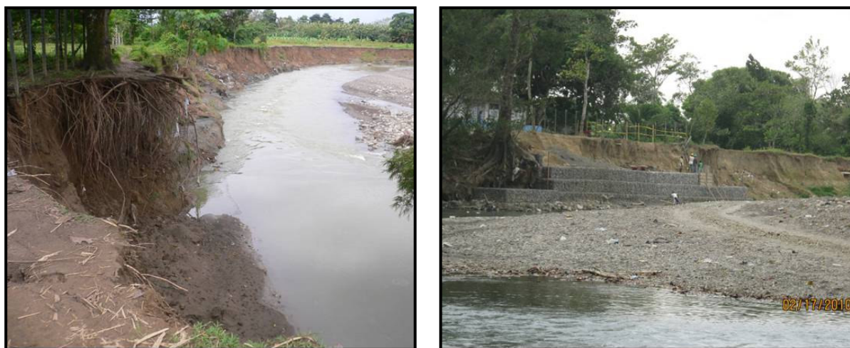
a) Aspecto de la falla
