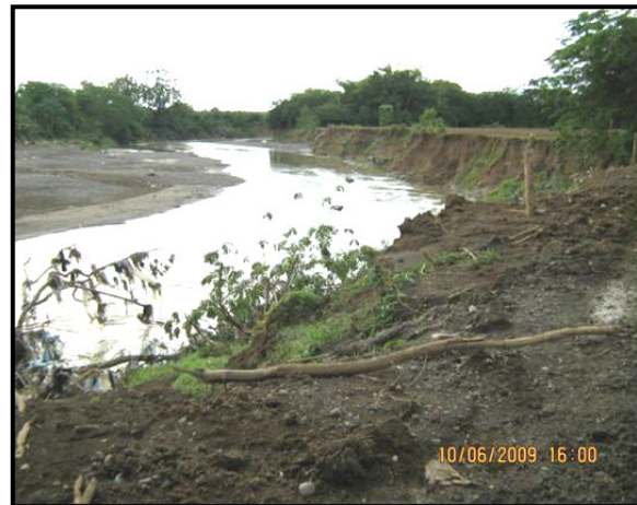
d) Socavación lateral de la terraza a la salida de la zona urbana del municipio
