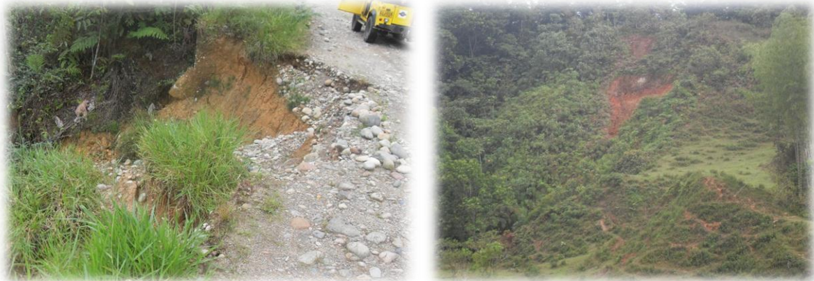
Figura 15. Deslizamiento del terreno
