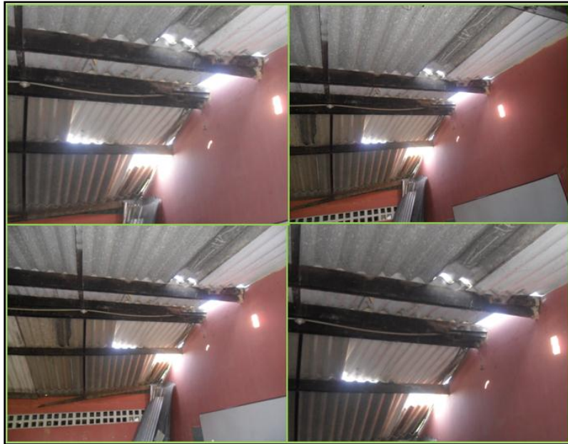
Figura 77. Afectación por vendavales en el centro educativo de Puerto Torres
