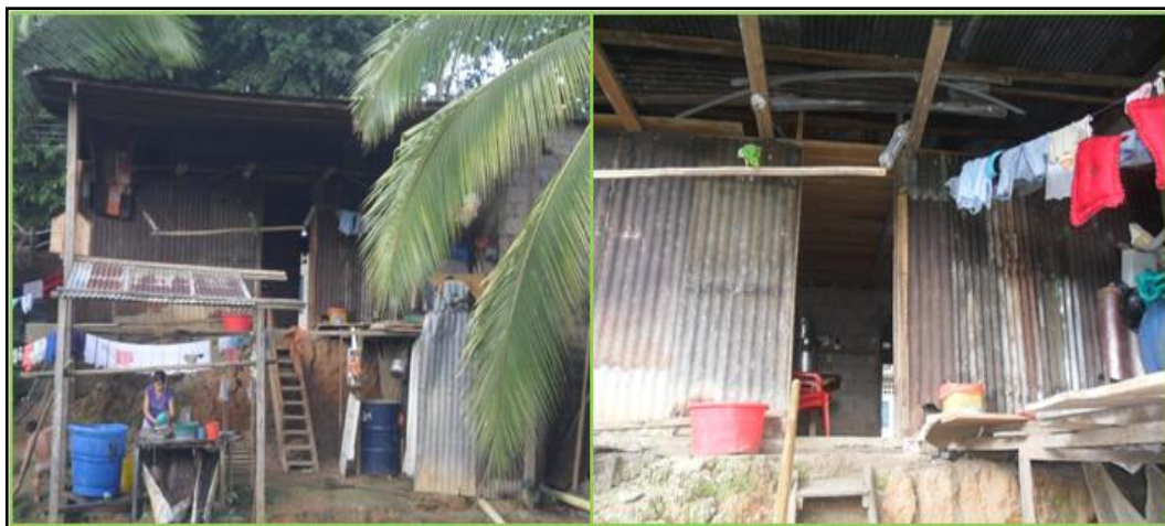
Figura 58. Edificación Tipo III en la zona urbana susceptible a explosión de combustibles
