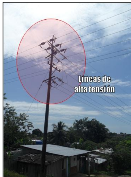
Figura 67. Red de distribución de energía en la zona urbana generadoras de contaminación electromagnética
