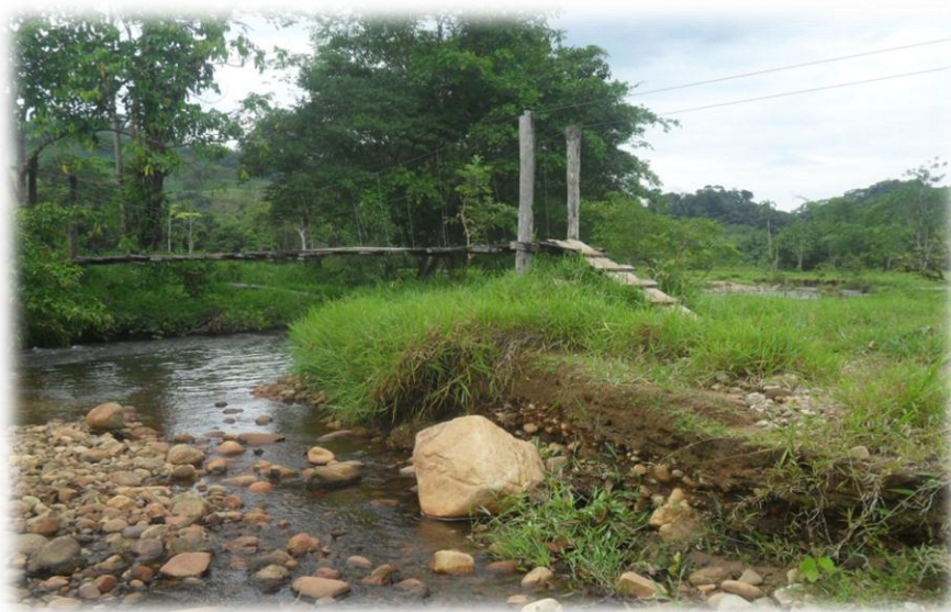
Figura 18. Socavación lateral del cauce de la quebrada Las Curvas (Los Ángeles)
