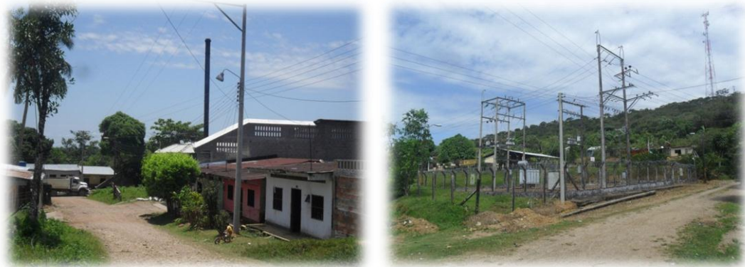
Figura 29. Líneas de alta tensión y subestación eléctrica
