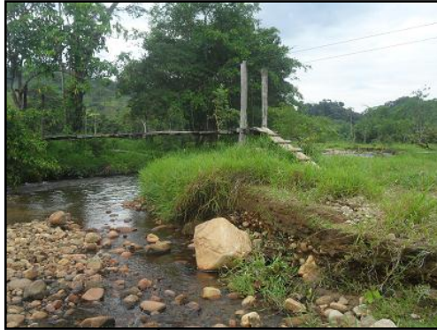
Figura 81. Zona rural susceptible a socavación en Los Ángeles
