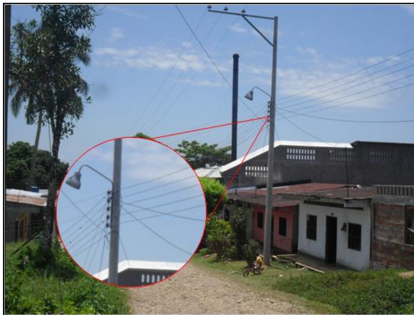
Figura 44. Líneas de energía y telecomunicaciones en la zona urbana que puede ser afectada por vendavales
