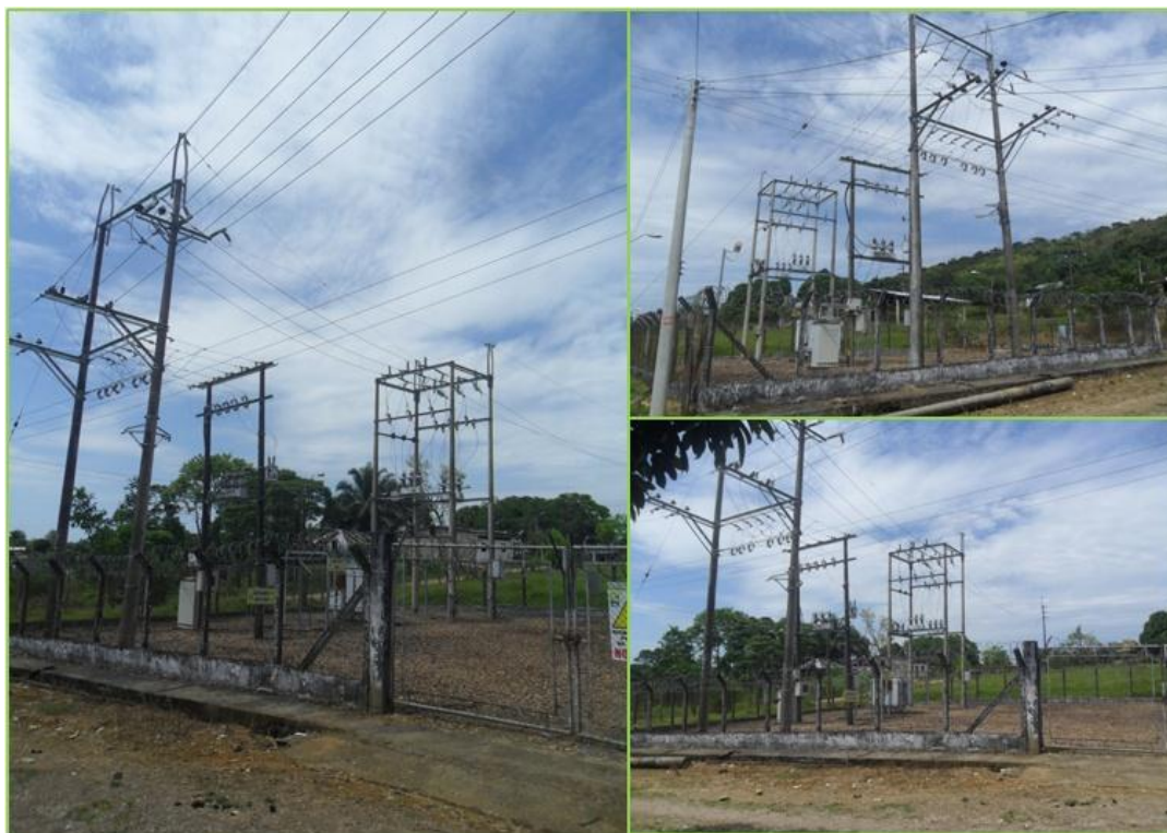
Figura 64. Subestación eléctrica Barrio Santa Teresa
