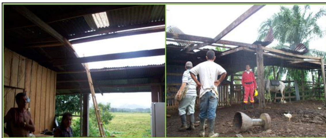
Figura 76. Vulnerabilidad estructural en la zona rural
