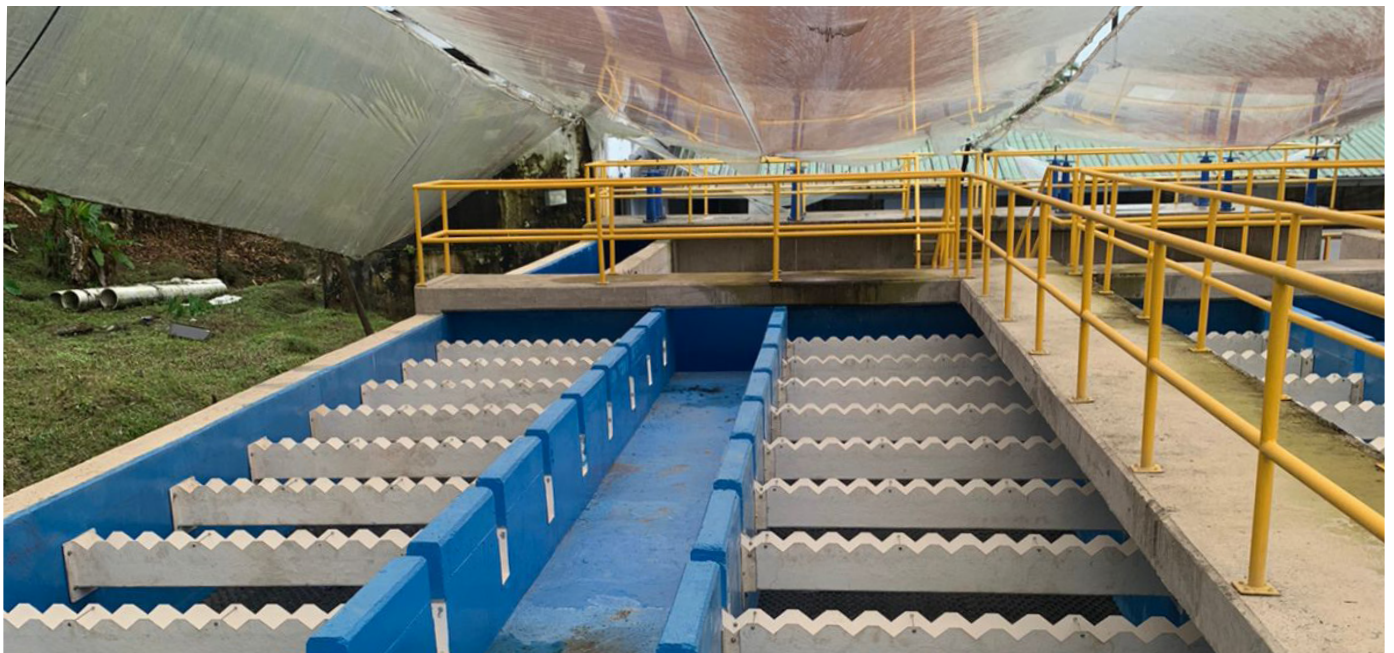
PLAYITAS 1 QUIBDÓ. Construcción de la planta de tratamiento La Playita I, Quibdó bajo invernadero para permitir la ejecución de obra bajo condiciones de lluvia.
