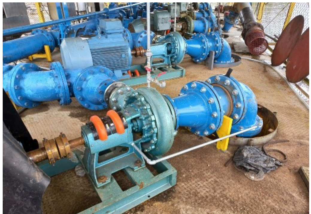
Suministro de bombas captación barcaza, Tumaco, Nariño.
