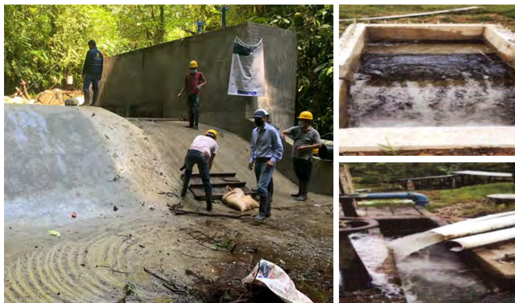
A la fecha hace un aporte de 150 LPS (llegada al desarenador de El Líbano) con capacidad para abastecer a una población de 150 mil habitantes. - PROYECTO ACUEDUCTO Y CONDUCCIÓN RÍO CHONTAYACO
