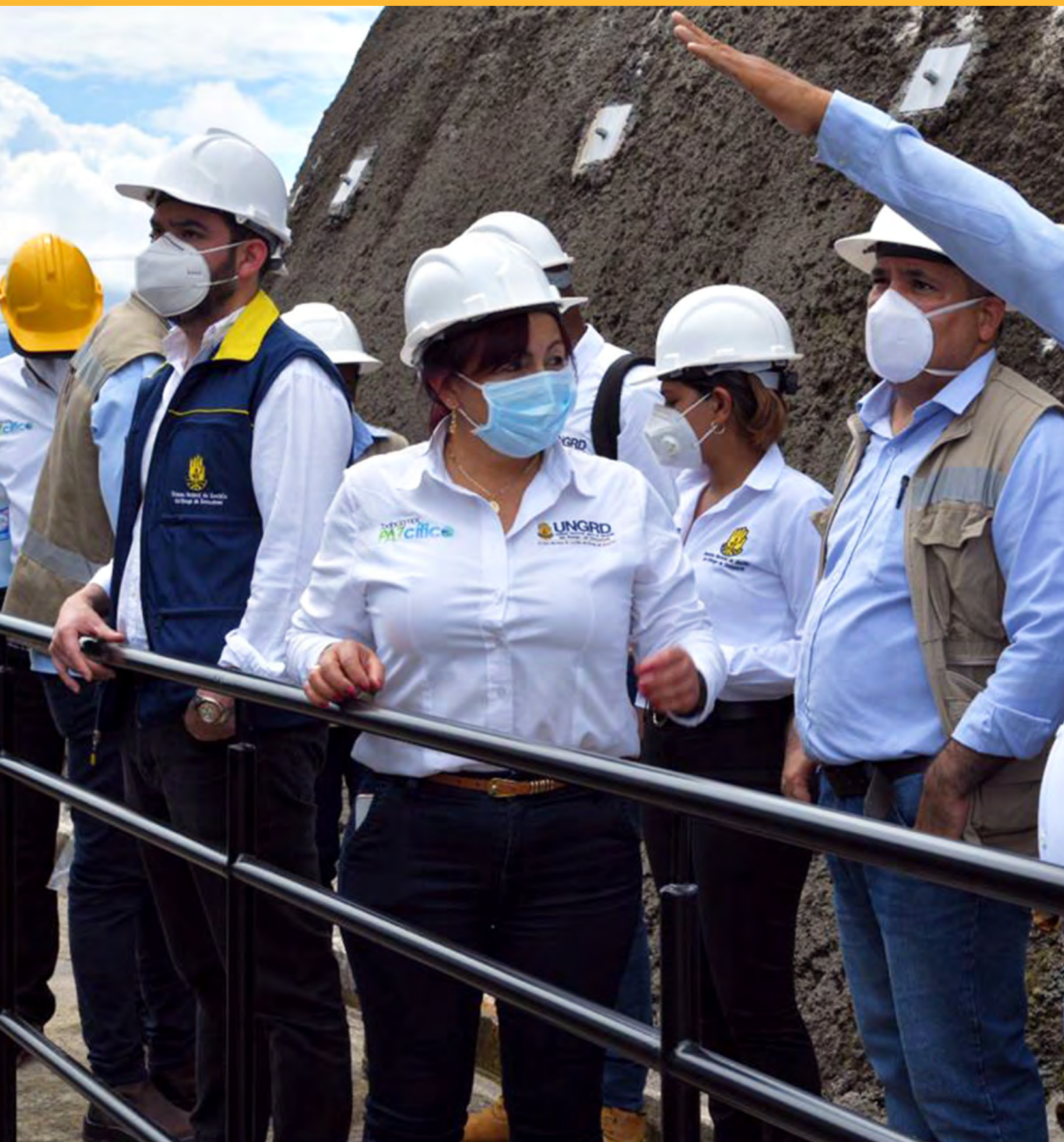
Visita a la obra de construcción de Tanques de almacenamiento de Agua potable Loma Alta - Buenaventura.
