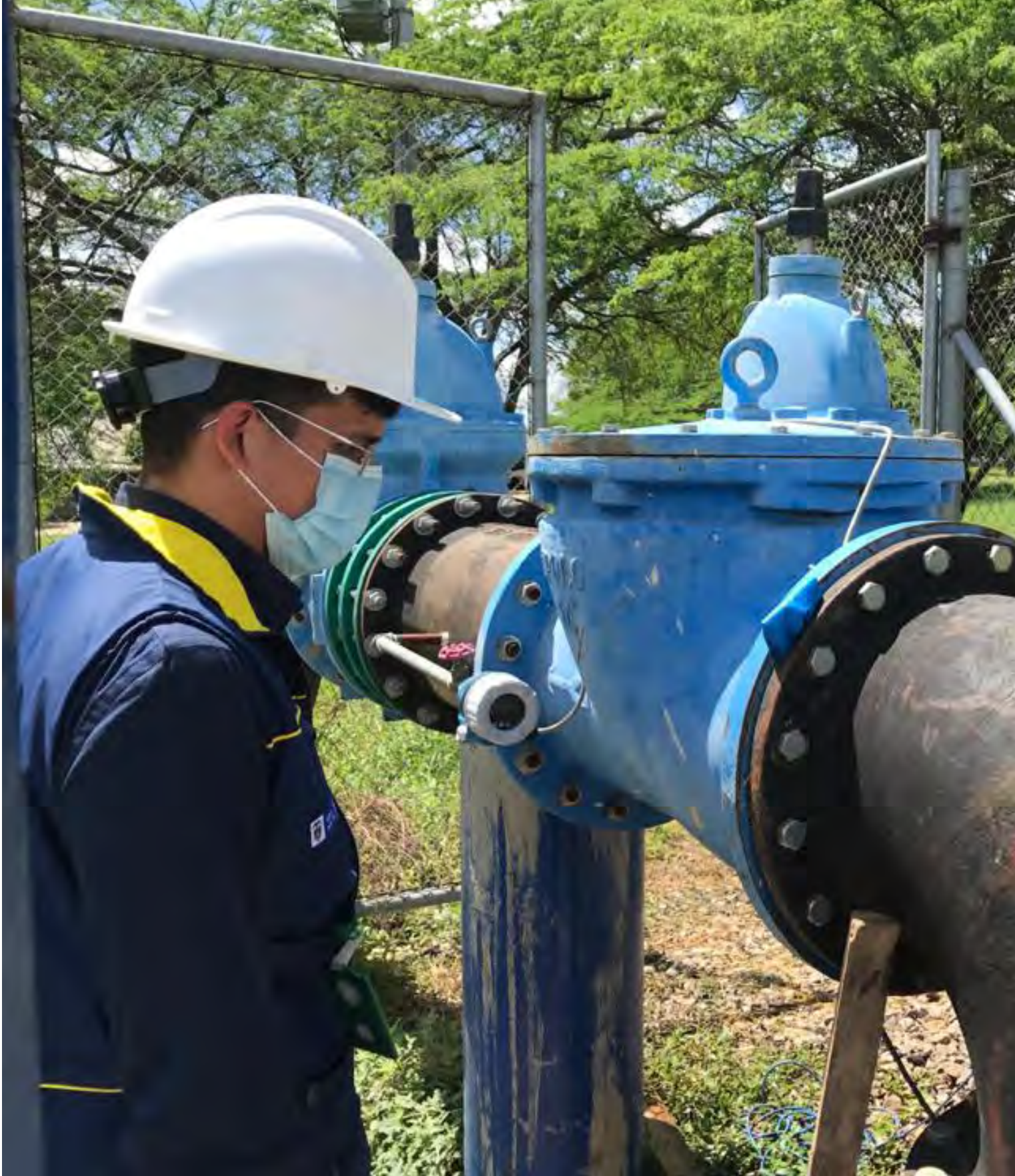
Seguimiento a los mantenimientos de los sistemas de respaldos de Riohacha
