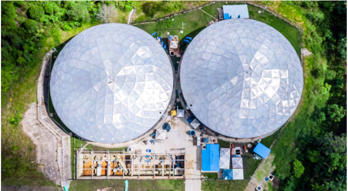
Tanques de almacenamiento de agua potable Loma Alta Buenaventura-Valle del Cauca
